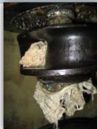
Pompe obstruée par un résidu solide
